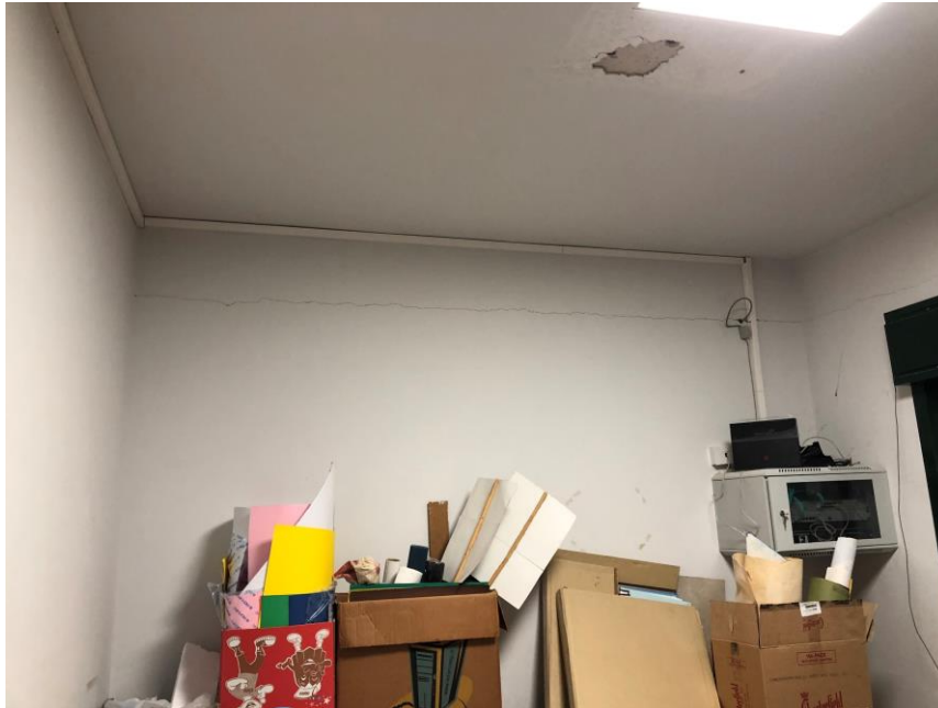
Figura 3.7 – Lesione orizzontale sotto trave nel ripostiglio
